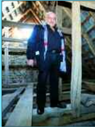
Klaus Ulrich im sanierungsbedürftigen Dachstuhl
