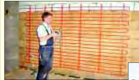
Die Installation einer Wandheizung hilft auch der Schimmelbildung vorzubeugen
